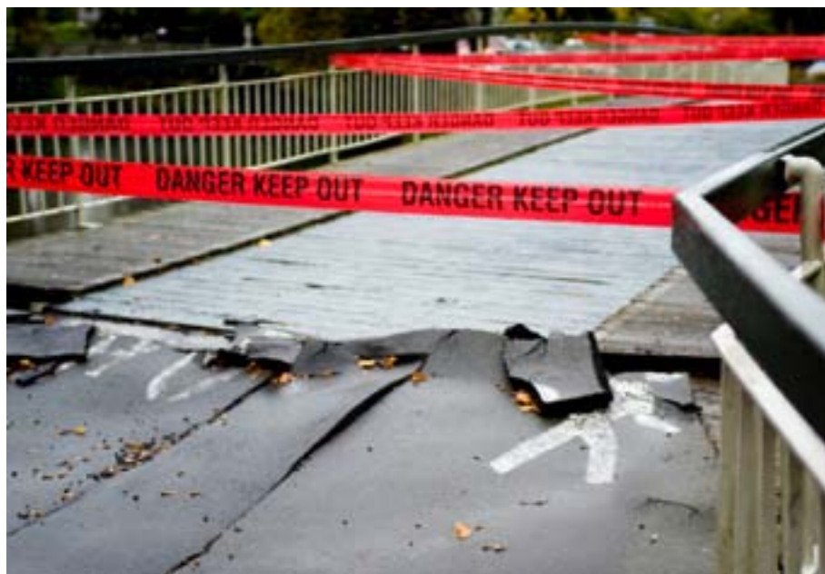
Après le séisme du 22 février 2011, une signalisation interdit de traverser un pont.
